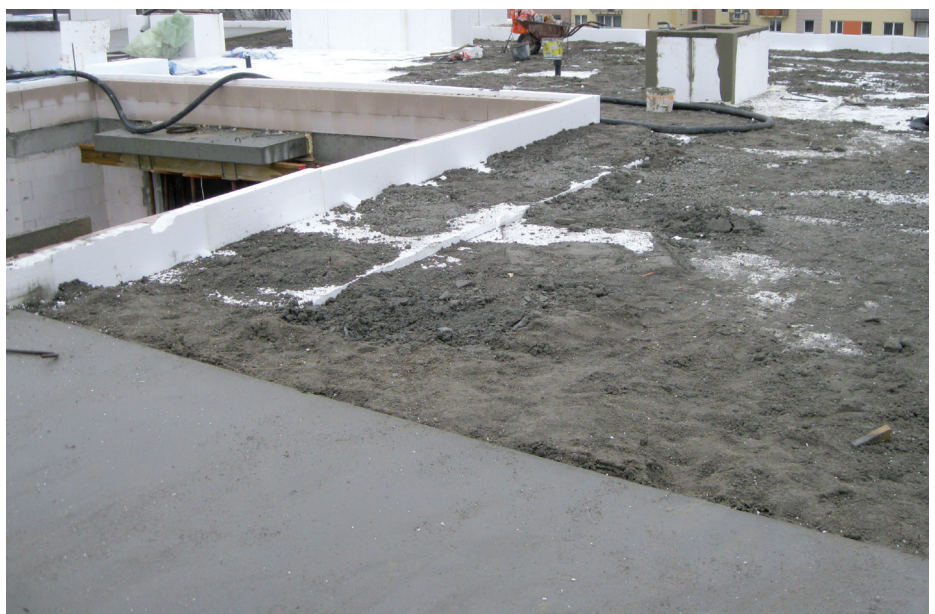
▲ Rys. 4. Przy okazji betonowania wykonawca wprowadza do stropodachu wodę, a następnie całość uszczelnia papą zgrzewalną
