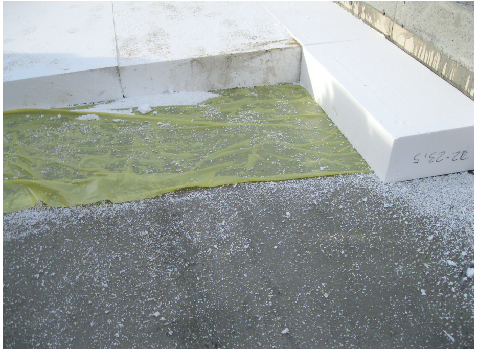
▲ Rys. 3. Folia PE nie zabezpieczy przed degradacją termoizolacji stropodachu niewentylowanego w warunkach budynku mieszkalnego
